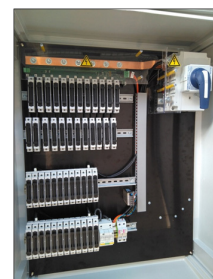
Figura 9 CcM-Shunt ejemplo de instalación
