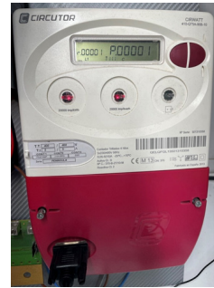
Figura 8 Conexión de cable DB9 en contador
